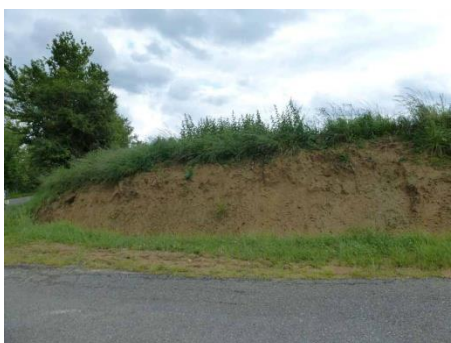
Erosion de talus
